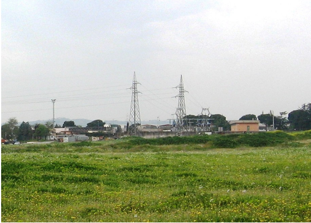
Foto 7: La Cabina Primaria Fiano Romano.
