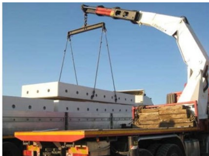
Figura 26 | Scarico cabina trasformazione
