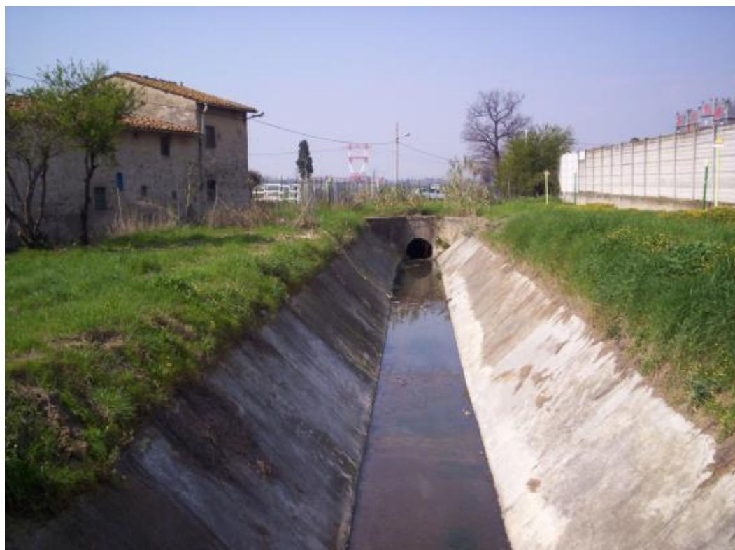
Figura 2-9 : Attraversamento n° 4. Tombino visto da monte.
