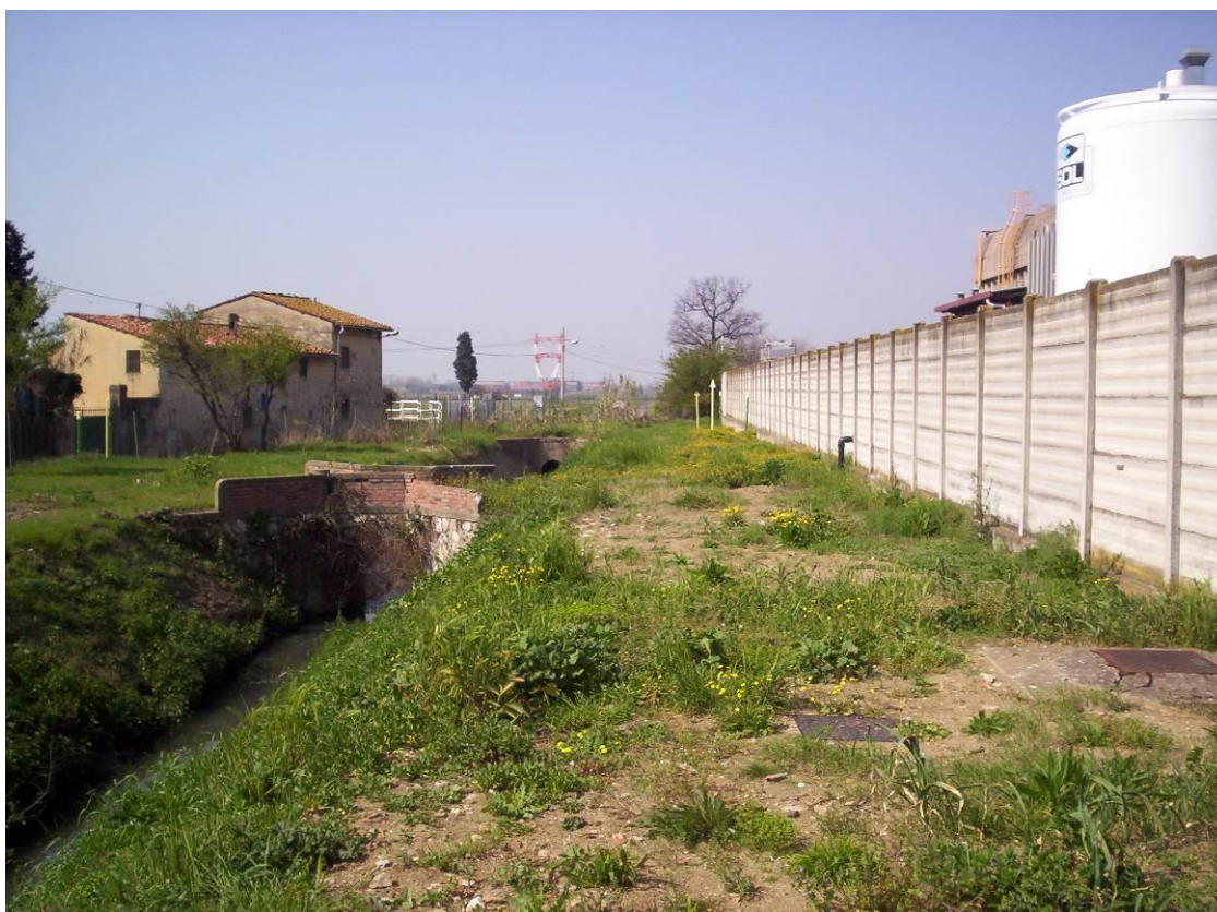
Figura 2-8 : Attraversamento n° 3. Tombino visto da monte.
