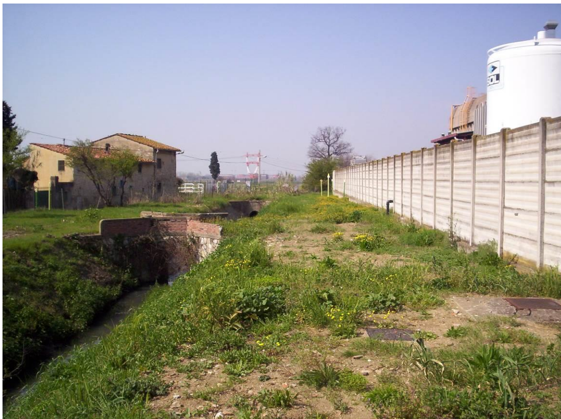
Figura 2-8 : Attraversamento n° 3. Tombino visto da monte.
