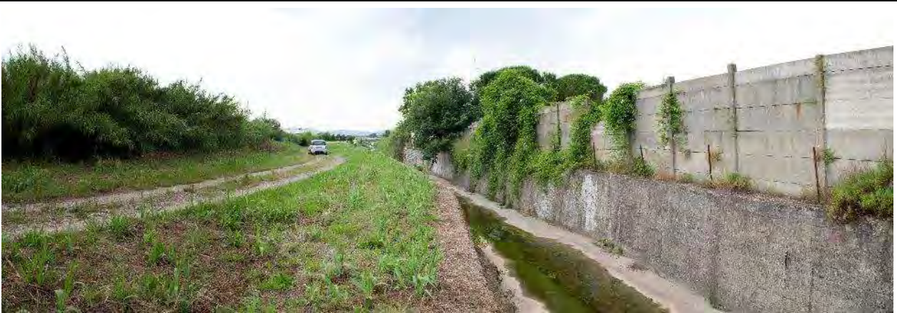
Vegetazione perifluviale ( domande 2-4 ): aspetto della sponda sinistra: è evidente la cementificazione dell'alveo e la presenza di una fascia di vegetazione spondale secondaria, priva di funzionalità significativa.
