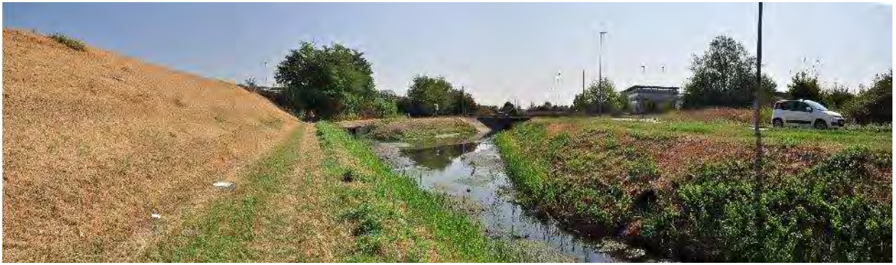
Stato del territorio circostante (domanda 1): Aspetto del canale all’inizio del tratto considerato: a monte della sponda destra, ad eccezione delle infrastrutture stradali (autostrada A11), l’area è prevalentemente occupata da parcelle agricole; in sponda sinistra, è presente un’estesa area urbanizzata (Osmannoro).
