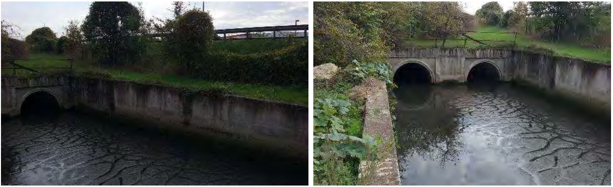
Stato dell'alveo (domande 5-9). A sinistra e a destra: sagomature artificiali degli argini del tratto in esame e dettaglio della tombatura dello stesso al termine del transetto di rilevamento.
