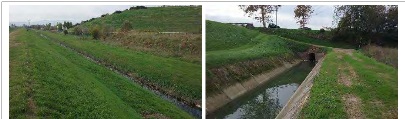
Sito ASUP-10 – Dettagli del canale presso l'inizio (a sinistra) e la fine (a destra) del tratto rilevato.
