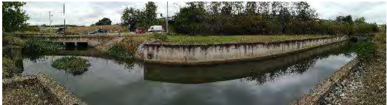
Sito ASUP-8 – Canale Colatore Sinistro, ripreso dall'argine sinistro; in secondo piano, sulla sinistra, via del Cantone.
