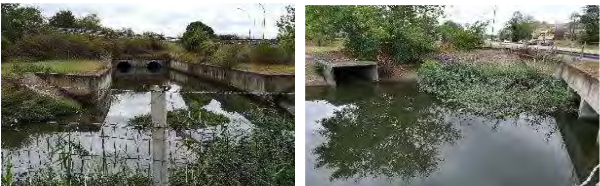
Vegetazione perifluviale (domande 2-4). A sinistra: dettaglio della conformazione spondale del tratto considerato: si nota l'impermeabilizzazione totale delle sponde e la quasi totale assenza della relativa vegetazione, ad eccezione della piccola isola vegetata presente al centro del tratto. A destra: formazione di Phragmites australis presente in fascia perifluviale primaria: considerandone la natura e la limitata estensione, si è scelto di procedere al rilievo unicamente della fascia perifluviale secondaria.
