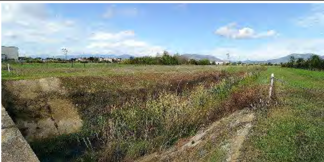
Sito ASUP-14 – Aspetto del canale ripreso dal ponte di Strada Vicinale del Manetti, in direzione N. L'alveo presenta una totale copertura a Thypha latifolia .
