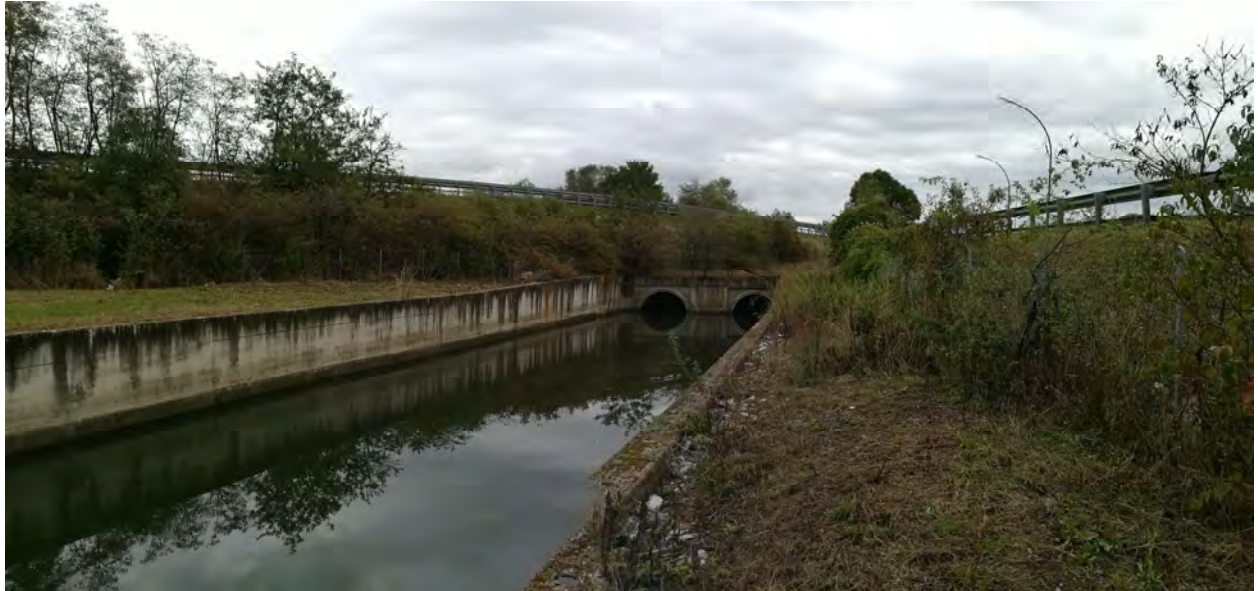
Canale Colatore Sinistro, ripreso nell'area interclusa da infrastrutture viarie (A11, via del Cantone) in loc. Osmannoro.
