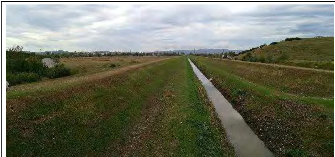
Fosso Reale a valle del ponte di Dogaia: in secondo piano sono visibili la discarica di Case Passerini (a destra) e alcune parcelle agricole (a sinistra). Nel tratto in esame le sponde appaiono sfilciate e parzialmente decorticate con mezzi meccanici.
