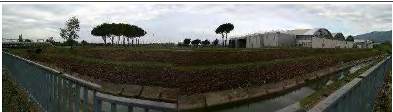
Stato dell'alveo (domande 5-9). Panoramica del tratto a valle della confluenza con il torrente Zambra; si nota la completa artificializzazione dell'alveo e la mancanza di elementi morfologici distinti.
