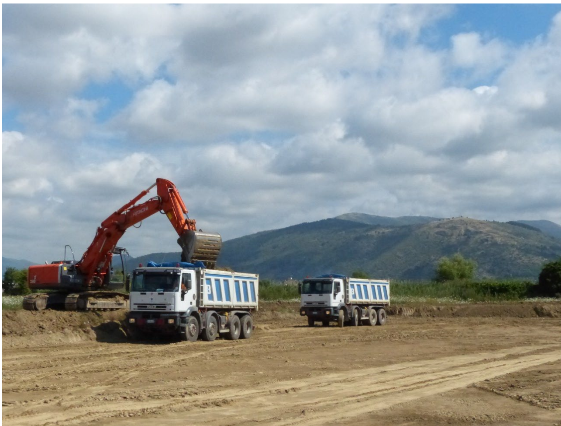
Figura 53 - Area di studio denominata "Zona BD17" ove è stato effettuato il Monitoraggio dei Chiroterteri durante il periodo 2017-2018: è mostrata un'immagine dei lavori inerenti la realizzazione di una nuova cassa di espansione idraulica da parte del Consorzio di Bonifica Medio Valdarno. Nell'ambito di questo progetto è prevista, su progettazione dello scrivente, la realizzazione di due nuovi ambienti umidi dedicati alla conservazione dell'erpetofauna e dell'avifauna (Foto Dr. Carlo Scoccianti, 16 marzo 2023)
