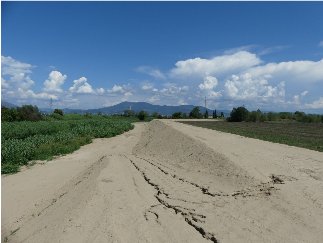
Figura 17 - Area di studio n. 9 ove è stato effettuato il Monitoraggio dell'avifauna durante il periodo 2015-2020): è mostrata un'immagine dei lavori di realizzazione dell'ampia cassa di espansione dei Renai di Signa (progetto Regione Toscana – Genio civile) (foto C. Scoccianti, agosto 2022)
