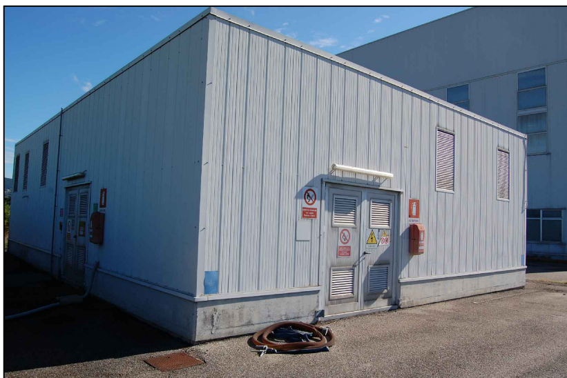
VISTA DELLA CENTRALE TECNOLOGICA
