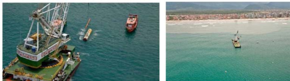
Figura 2.3: Mezzi per Recupero della TBM (Pontone con gru e mezzo di supporto)
