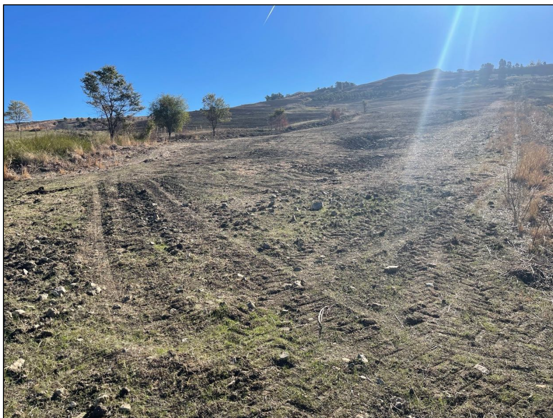
Foto 7 - Panoramica UR 03 (Impianto)
