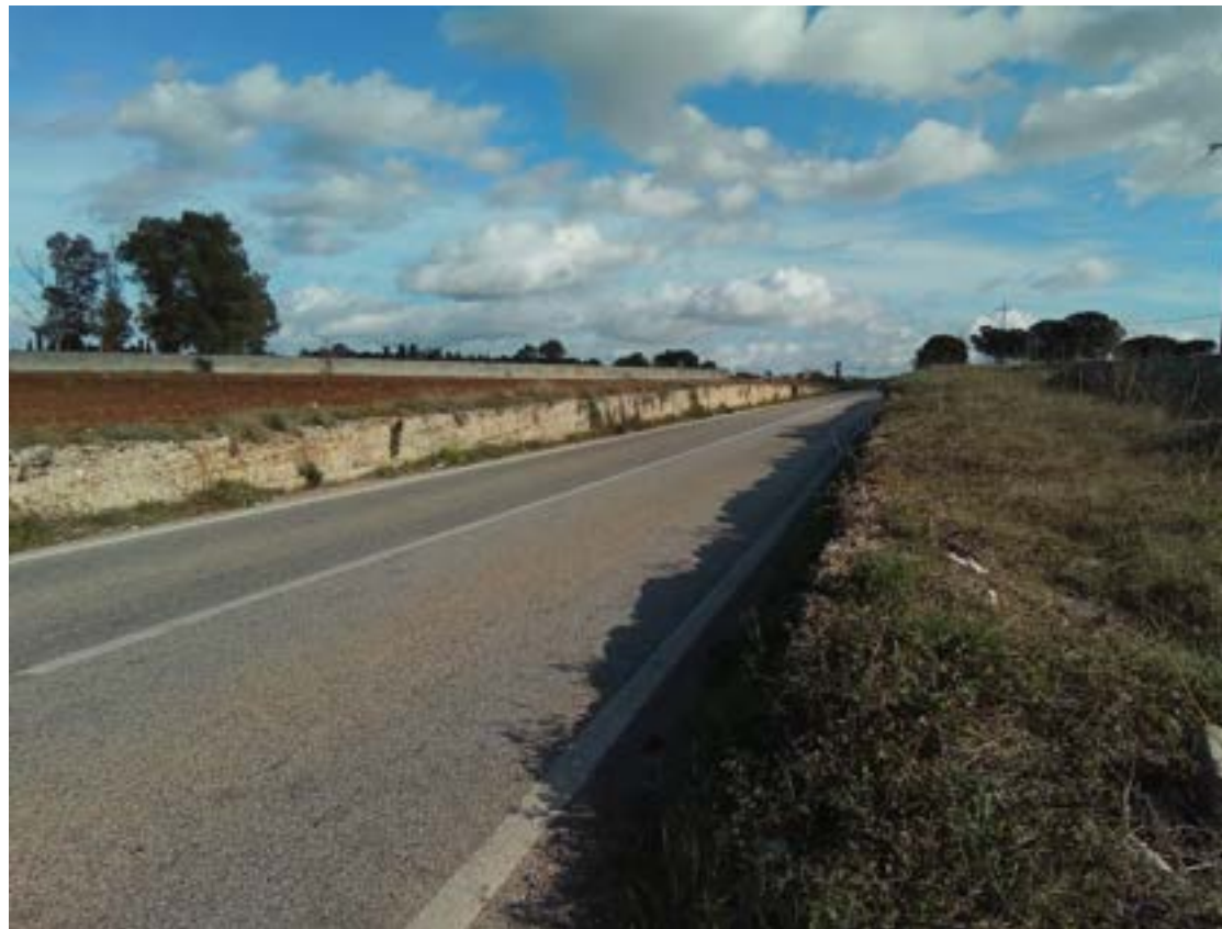
Area con muro e rialzo ai lati della strada interessata dalle lavorazioni
