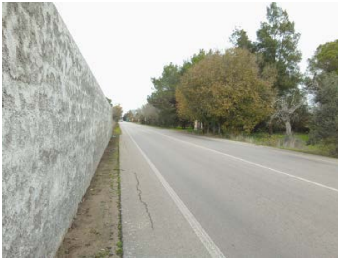
Strada con area privata su un lato e area con vegetazione sull'altro lato
