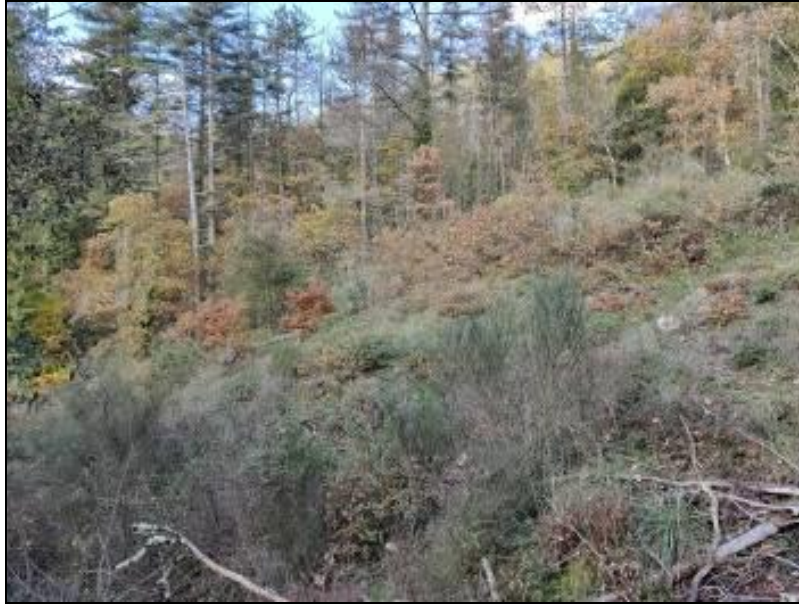
Figura 7-52 Panoramica del dissesto rilevato.
