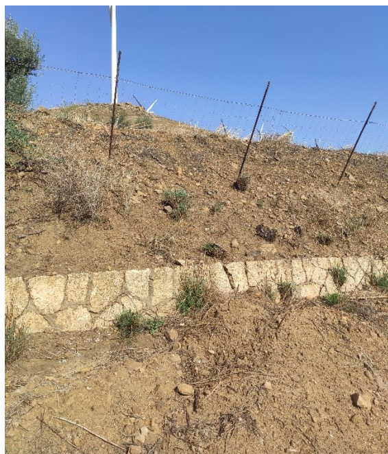
Figura 9 – Terreni colluviali accumulati nella parte inferiore dei versanti a seguito dell'erosione ad opera delle acque di ruscellamento
