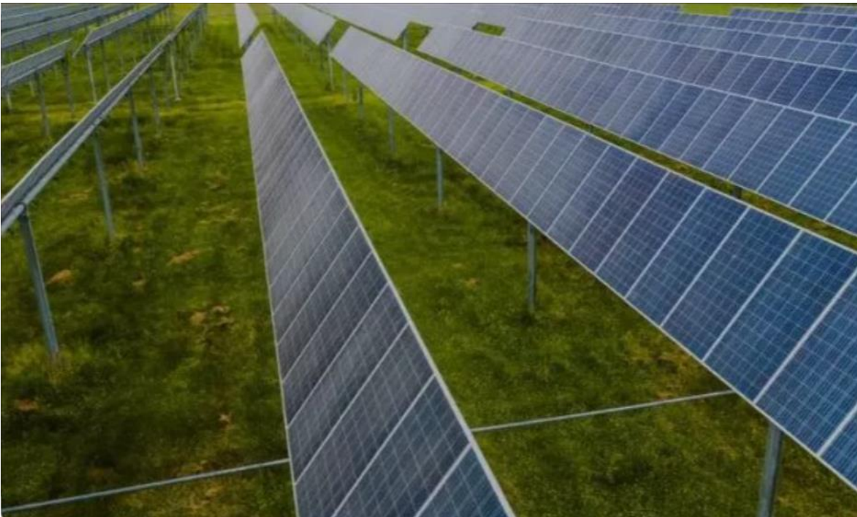
Figura 2-13: Campo fotovoltaico su inseguitori mono assiali con singolo modulo
