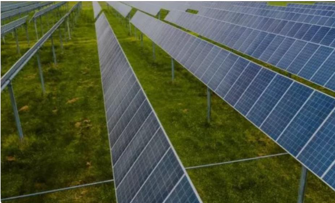
Figura 1-18: Campo fotovoltaico su inseguitori mono assiali con singolo modulo
