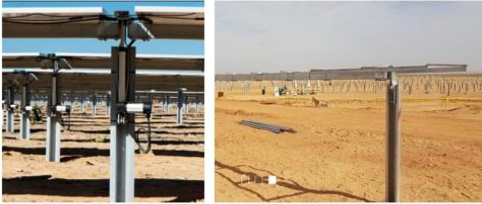
Figura 8. Particolare strutture ad inseguimento ed attuatore
