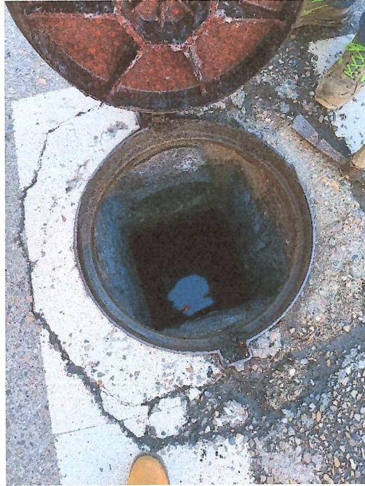
Foto 5. Fognatura scatolare cls 1100x2100 – angolo via Circondaria/via Sighele
