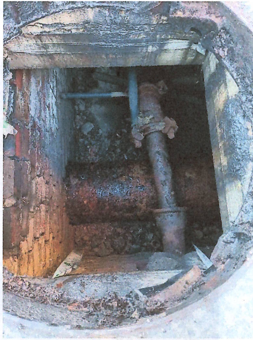
Foto 1. Acquedotto in Ghisa DN 400 – angolo via Circondaria/via Cironi
