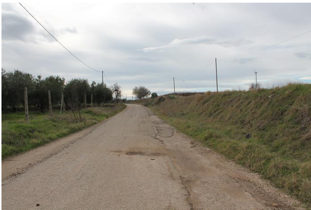
54 - San Paolo di Civitate (FG), s.c. Camerata, UR 4, panoramimca in direzione O, del segmento di cavidotto di connessione tra gli impianti WGT 7 e WGT 3
