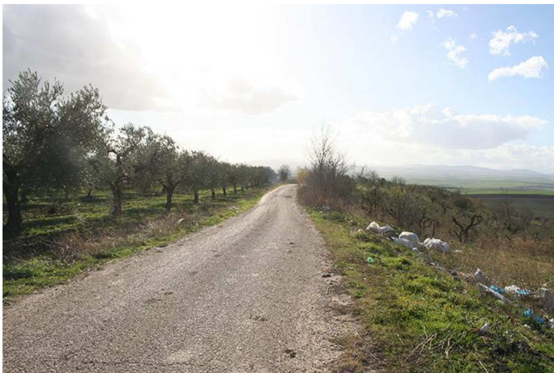
64 – San Paolo di Civitate (FG) UR 4 segmento di cavidotto di connessione corrente su s.c. Camerata verso incrocio con SP 46 direzione SO
