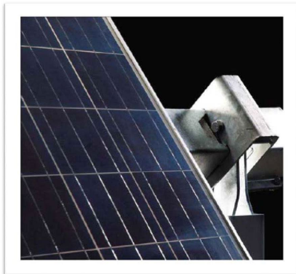
Figura 6.4. – Strutture di sostegno dei moduli fotovoltaici.
