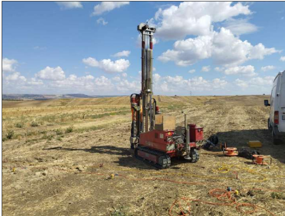
Foto Postazione Prova WTG9
