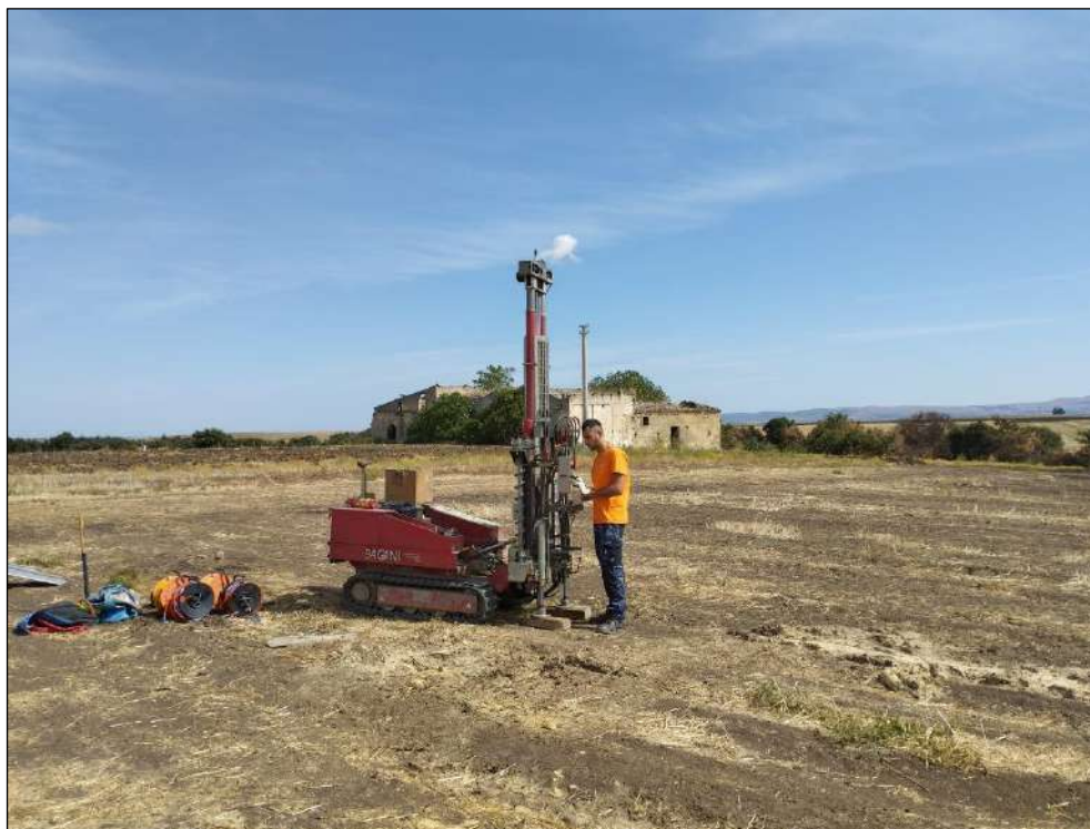
Foto Postazione Prova WTG6
