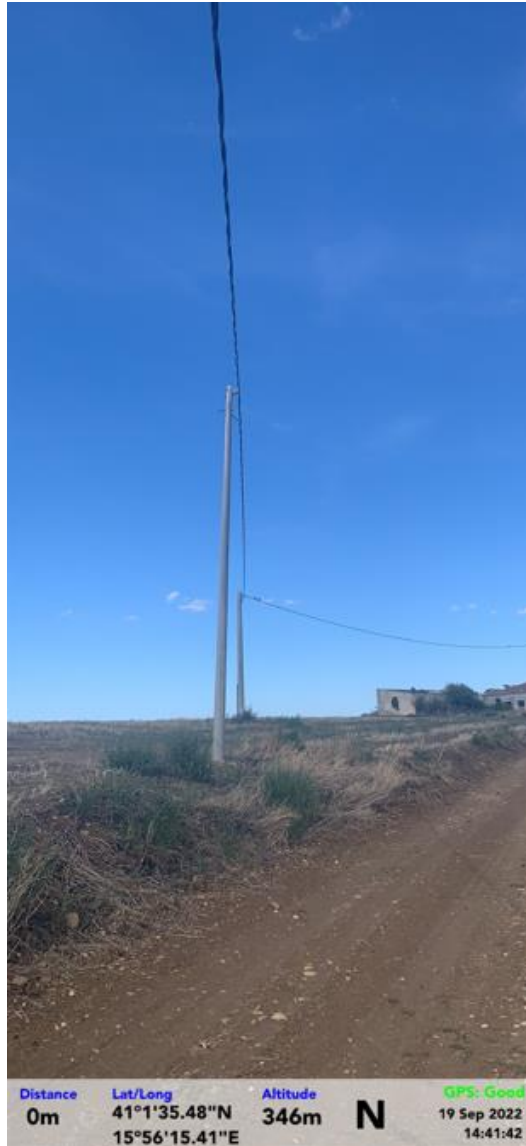
Figura 111 - Interferenza con linea elettrica di bassa tensione - Punto di scatto 4280
