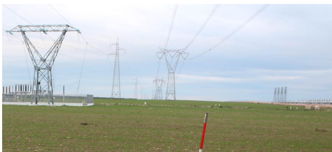
Foto P15: Vista dall'area di installazione della Sottostazione di Consegna
