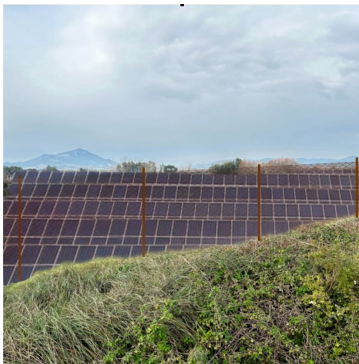
Vista di un impianto privo di schermatura
