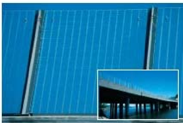
Esempio di trattamento di superfici trasparenti atto ad evitare le collisioni con l'avifauna (da COST 341)
