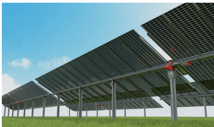
Figura 9-2 - Esempio di impianto con inseguitori solari monoassiali 2P
