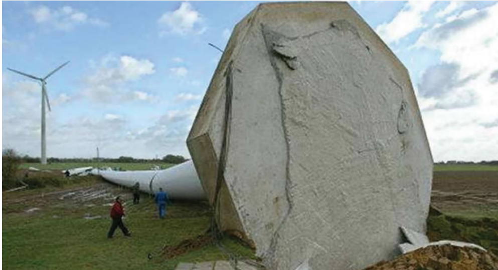
Figura 9- Ribaltamento della torre e del plinto
