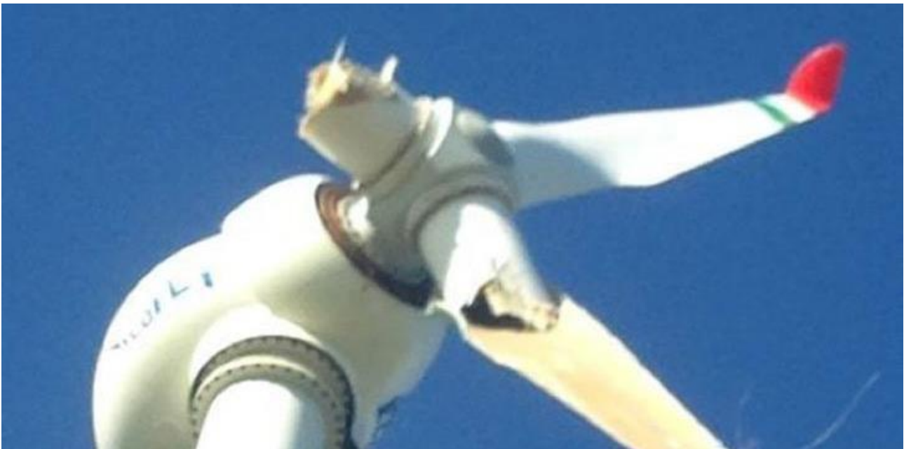
Figura 5- Esempio di rottura alla radice
