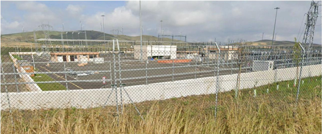
Figura 8-2 – Esempio stazione elettrica Terna di Vizzini a 380 kV
