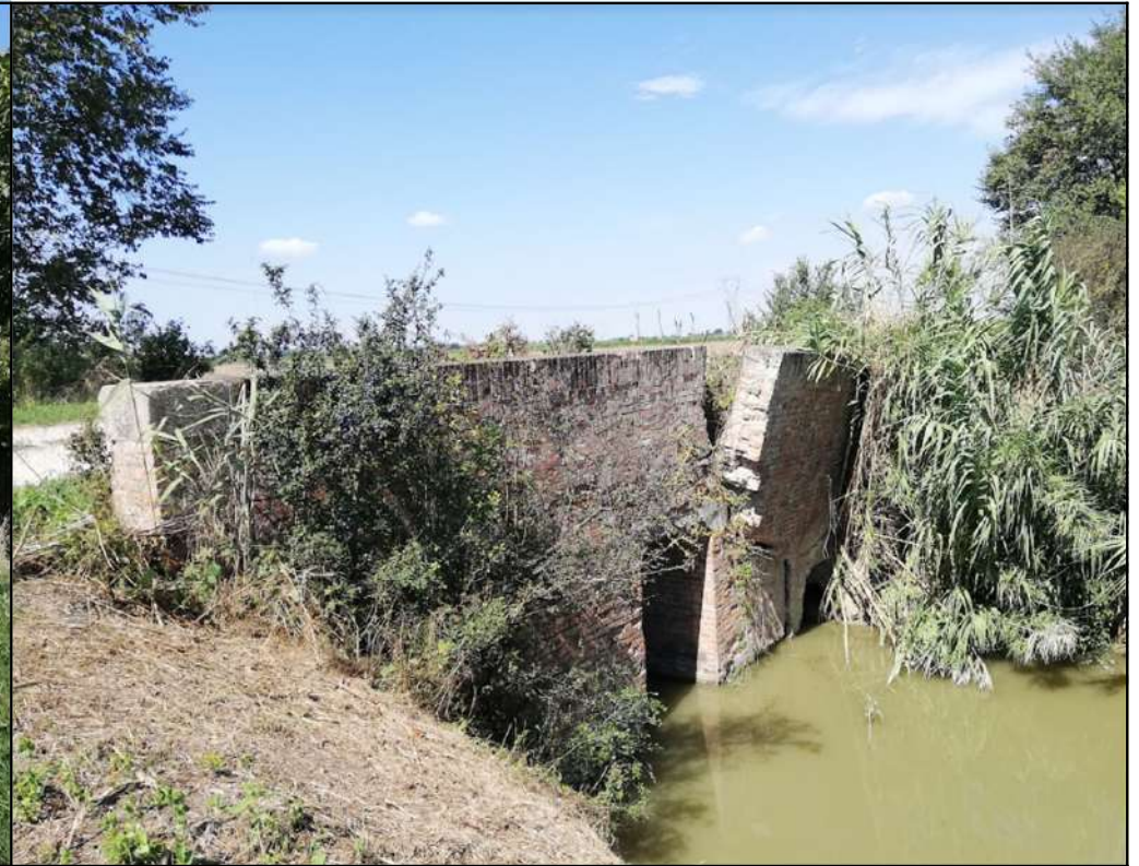
Ponte non idoneo lato nord
