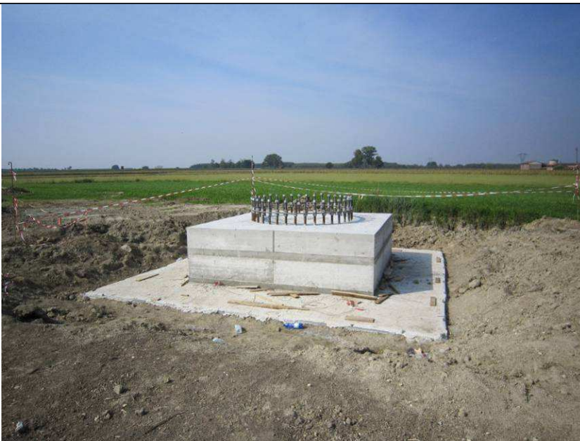
Realizzazione di fondazioni superficiali tipo plinto a monoblocco per un sostegno monostelo. Nell'immagine si può osservare una fondazione appena realizzata. Si può distinguere facilmente la flangia metallica dotata di tirafondi di raccordo con la parte in elevazione
