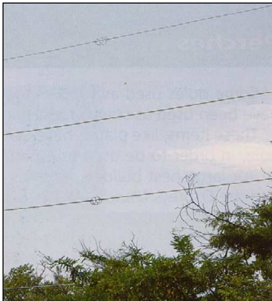
Spirali su cavi conduttori
