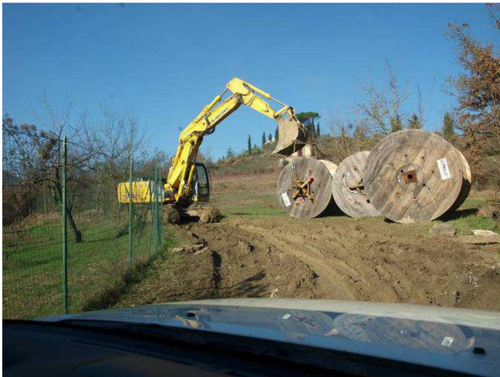
Trasporto dei conduttori tramite piste temporanee che vanno poi ripristinate a fine lavori
