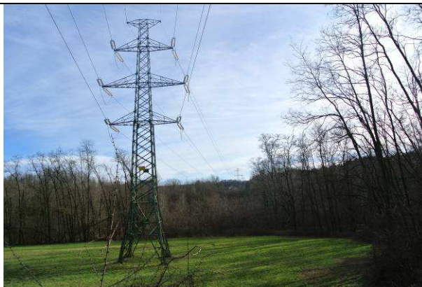
Sostegni a traliccio
