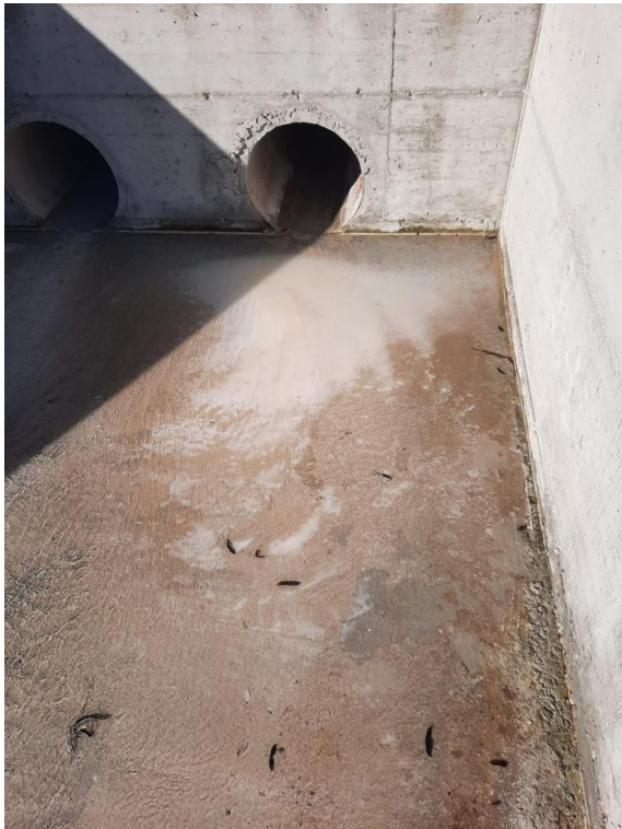
Figura 2: A sinistra scarico microtunnel, a destra scarico non ancora attivo delle acque provenienti dall'impianto di sollevamento – Vista frontale (27/03/2023)
