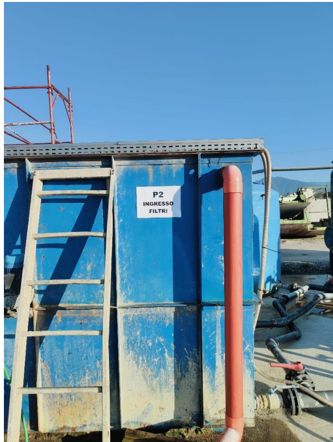
Foto 2: P2 - Ingresso filtri
