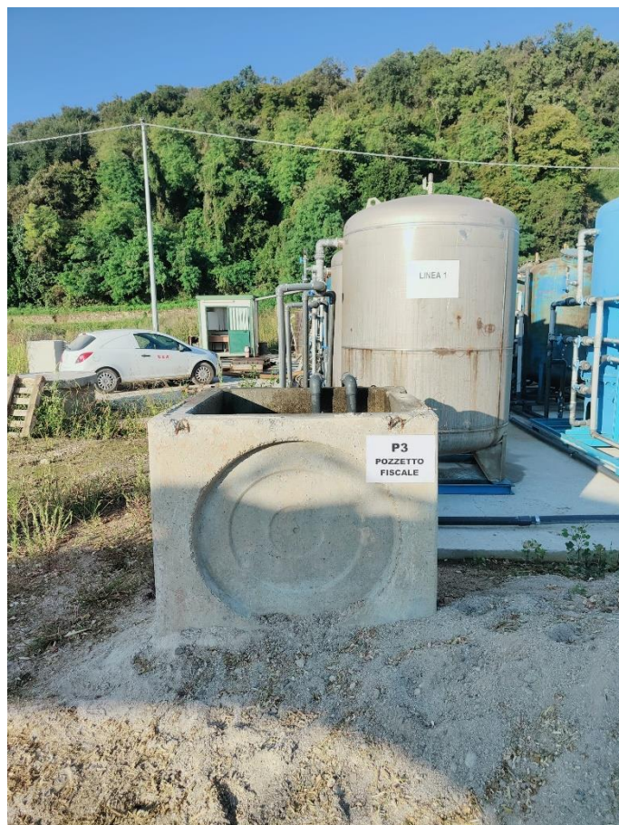
Foto 3: P3 - pozzetto fiscale
