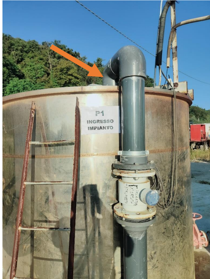
Foto 1 P1 - Ingresso impianto (da tubazione di sollevamento)
