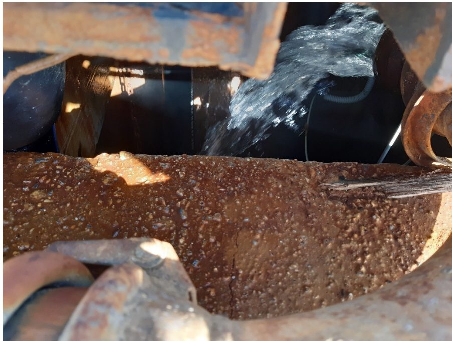
Foto 2. Dettaglio dell'immissione nella vasca di ingresso dei tubi di "troppo pieno" della vasca di omogeneizzazione e della vasca di accumulo. Vi era fuoriuscita d'acqua solo dal tubo relativo alla vasca di accumulo per rilancio ai filtri.
