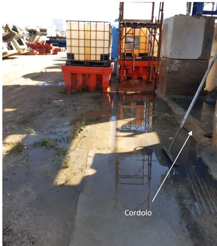
Foto 5. Dispersioni di acqua derivante dalla filtropressa su pavimentazione in cemento oltre il cordolo e anche su pavimentazione in stabilizzato, riscontrata nella mattinata del 19/09/2023
