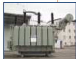
40 MVA 150/10,5 kV ONAN
