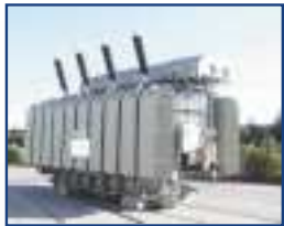
31,5 MVA 115/21 kV ONAN
