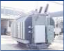
40 MVA 115/21 kV ONAF
