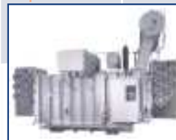
31,5/40 MVA 120/22 kV ONAF
