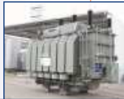
31,5/40 MVA 120/22 kV ONAF
