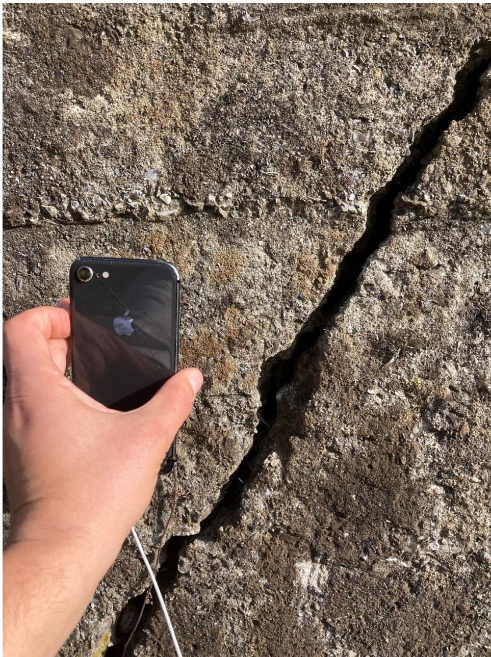
Figura 55 – Muro in calcestruzzo sulla sinistra della futura briglia. Dettaglio della fessura di Figura 53
