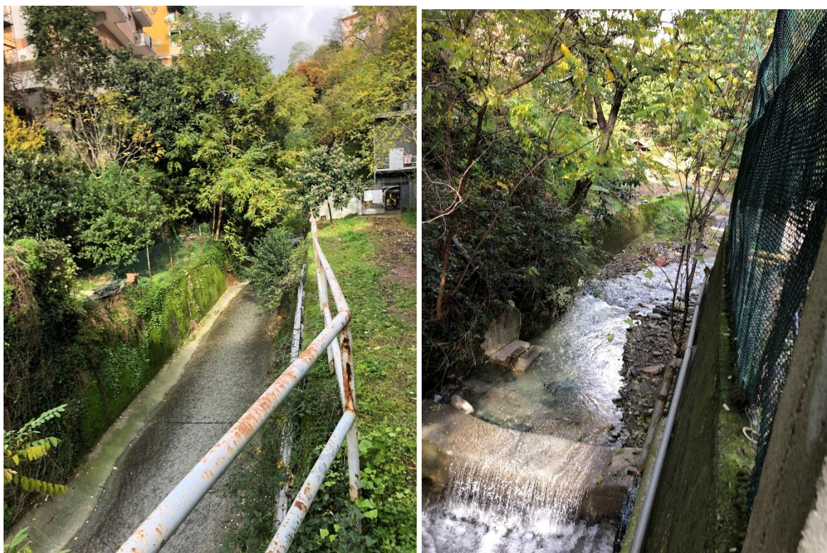
Figura 61: Stato di fatto nell'area di monte (immagine sx) e salto di fondo a monte della sezione 73bis e camera a valvole in sponda sinistra (immagine dx)
