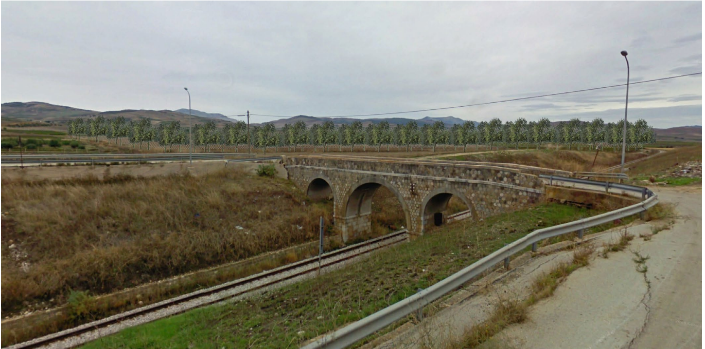
Figura 27 - Fotoinserimento A - stato POST operam impianto
