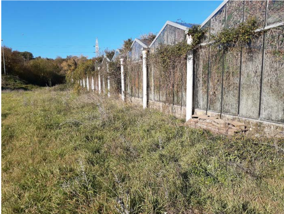
Figura 3.1.f Immagine dell'area delle serre in avanzato stato di degrado
