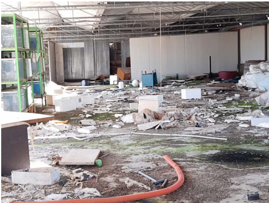
Figura 3.1.g Immagine degli interni dell'area delle serre in avanzato stato di degrado
