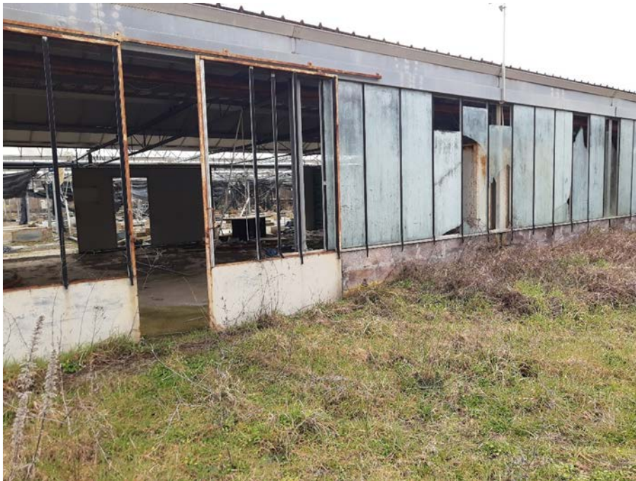
Figura 3.1.h Immagine dell'area delle serre in avanzato stato di degrado
