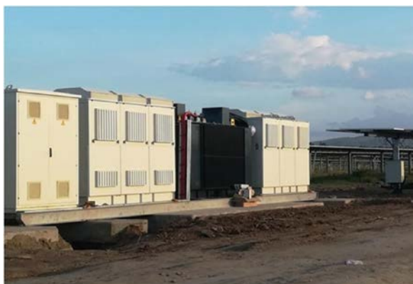
Esempio skid conversione
