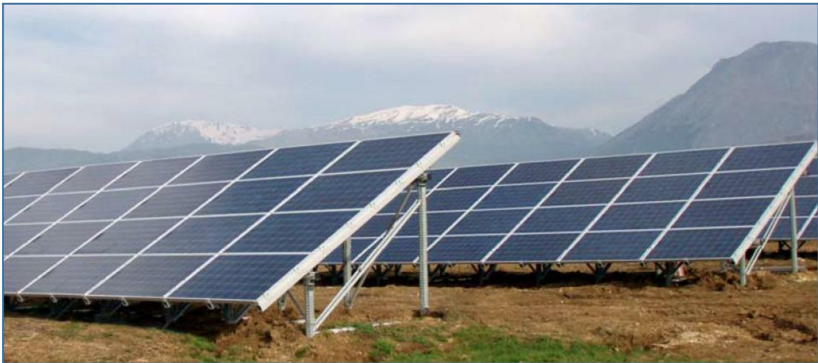
FIGURA 13: ISTALLAZIONE CON 4 MODULI IN ORIZZONTALE SU STRUTTURA FISSA
