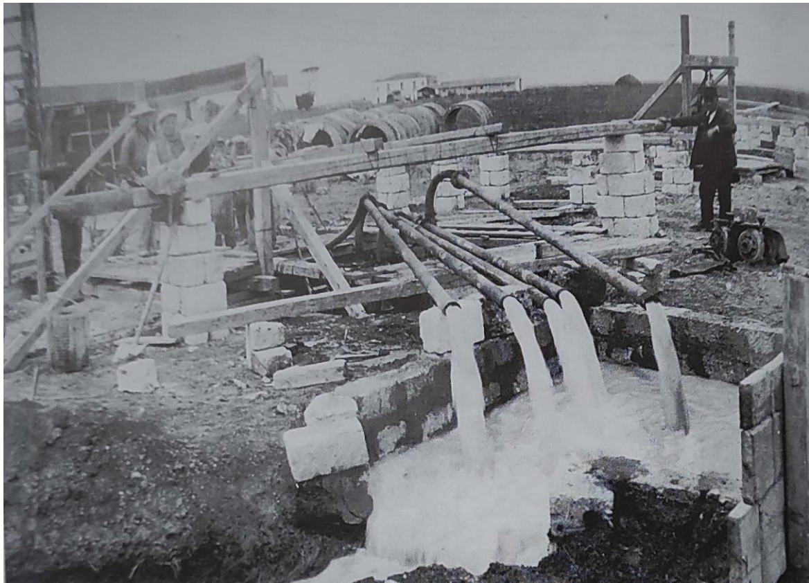
Figura 68 Arneo. Pozzo di irrigazione (MAINARDI 1997, p.38)
