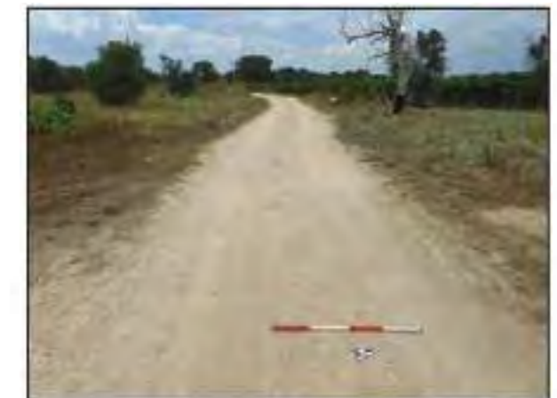
534 Proseguimento tracciato cavidotto su strada sterrata or. NW-SW
