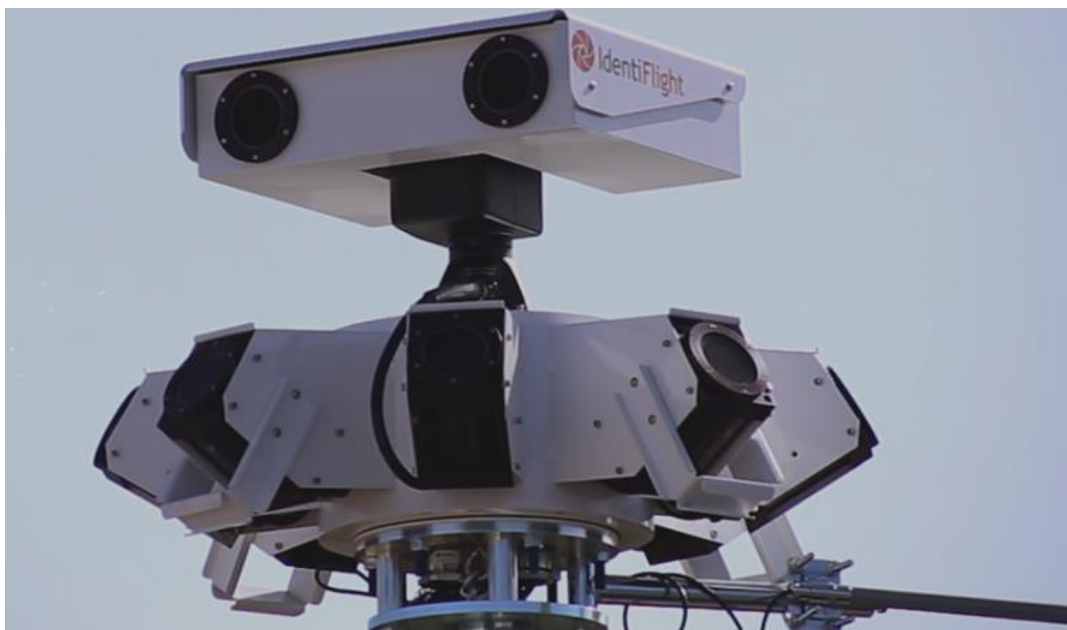
Figura 8: Il sistema IdentiFlight © composto da telecamere ad alta definizione mobili in grado di seguire individui di avifauna target e di agire attraverso un apposito software di intelligenza artificiale con l'automatico curtailment della o delle turbine eoliche collegate. Il software stabilisce le specie da riconoscere e da attenzionare strettamente intorno alla turbina ed imposta una sorta di cilindro virtuale intorno e sopra la stessa turbina (di solito con un raggio di 400 metri all'intorno e 200 metri sopra rispetto all'area di rotazione delle pale). Solo nel caso di "ingresso" in quest'area critica si attiva il blocco automatico della turbina.
