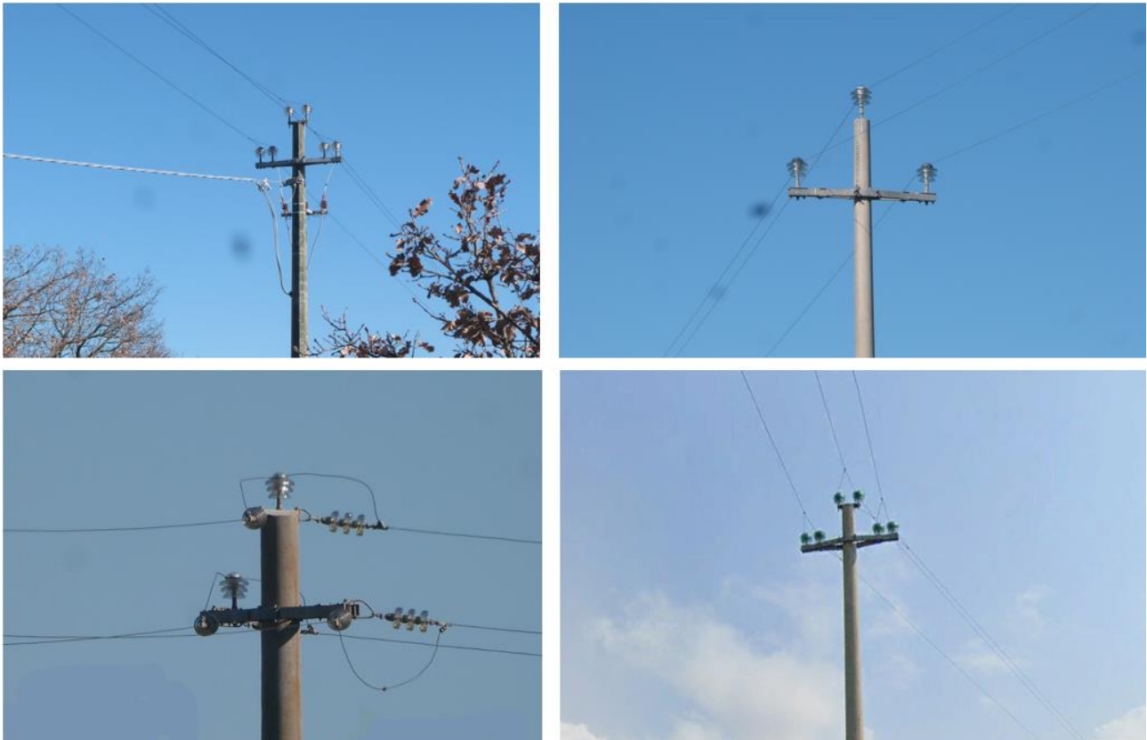
Figura 5. Esempi di tralicci delle linee elettriche MT e BT presenti nell'Area di Progetto e che possono avere un impatto per elettrocuzione sull'avifauna presente.
