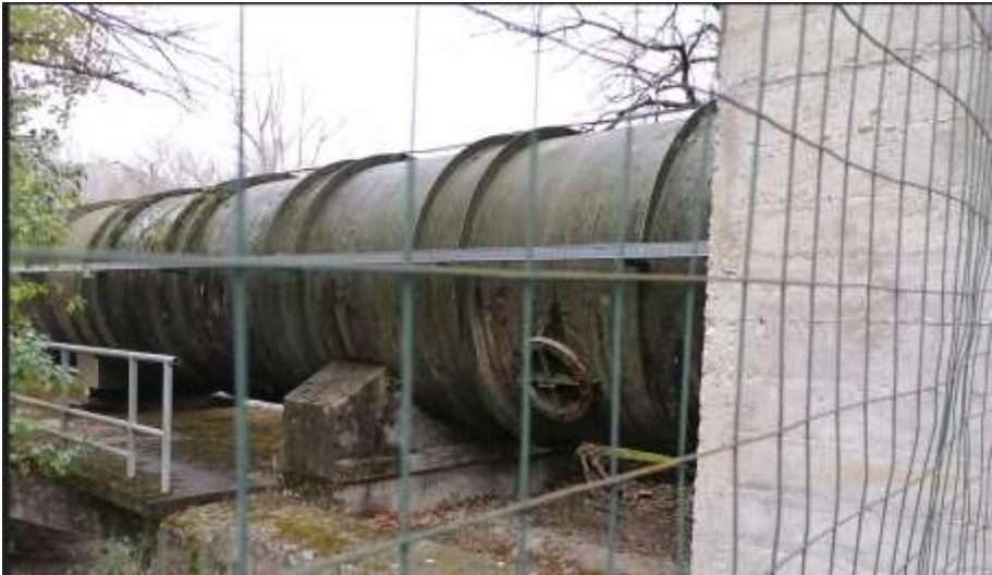
Figura 10: presa diretta dalla condotta di adduzione – presa dal lago di Casoli
