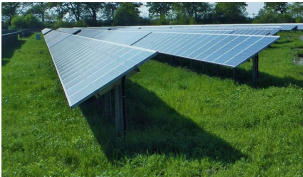
Erbaio permanente all'interno del parco agrivoltaico
