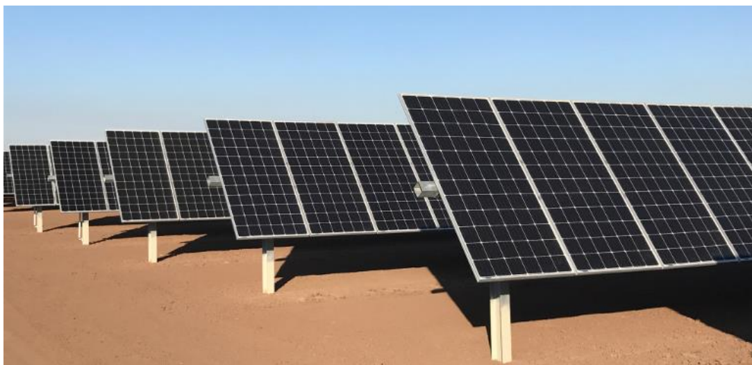
Strutture di supporto "Tracker mono-assiale"
