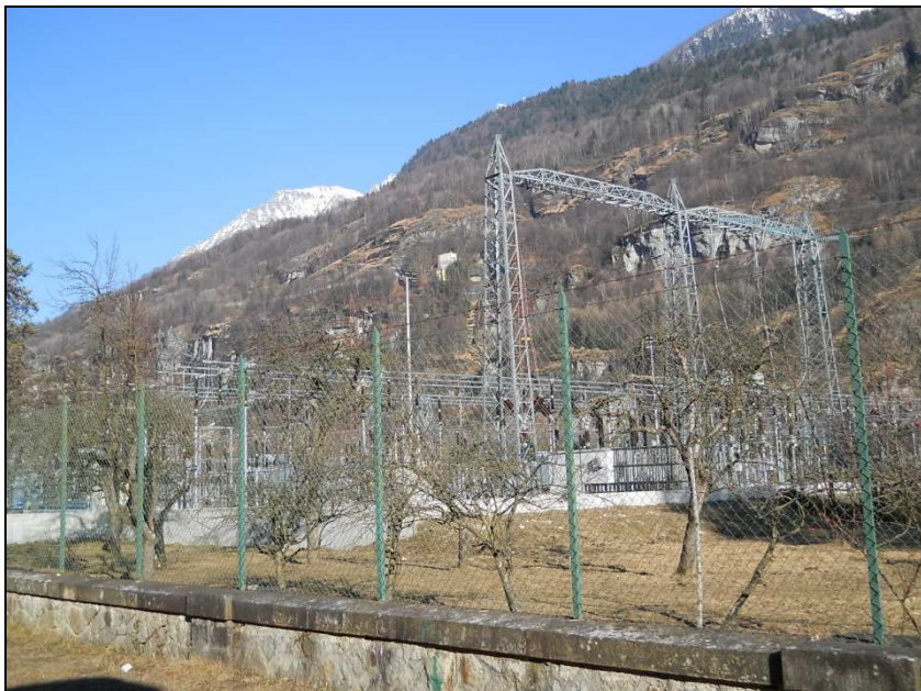
Fig. 9. La stazione di arrivo delle linee dell'elettrodotto a Verampio.
