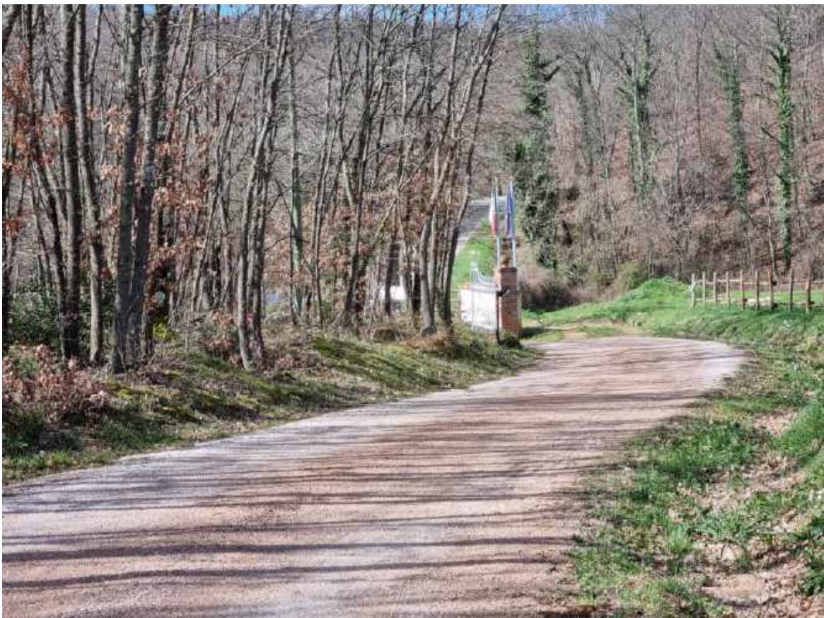
Figura 21 – area del cavidotto relativo a WTG 4 in prossimità dell'innesto con la SP Campigliola
