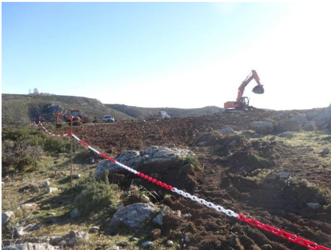
Figura 7 - Esempio di delimitazione dell'area di cantiere finalizzata all'esclusione delle superfici limitrofe. Fonte: Sardeolica, Relazione tecnica relativa alla fase di cantiere per l'ampliamento del parco eolico "Maistu" – Ulassai
